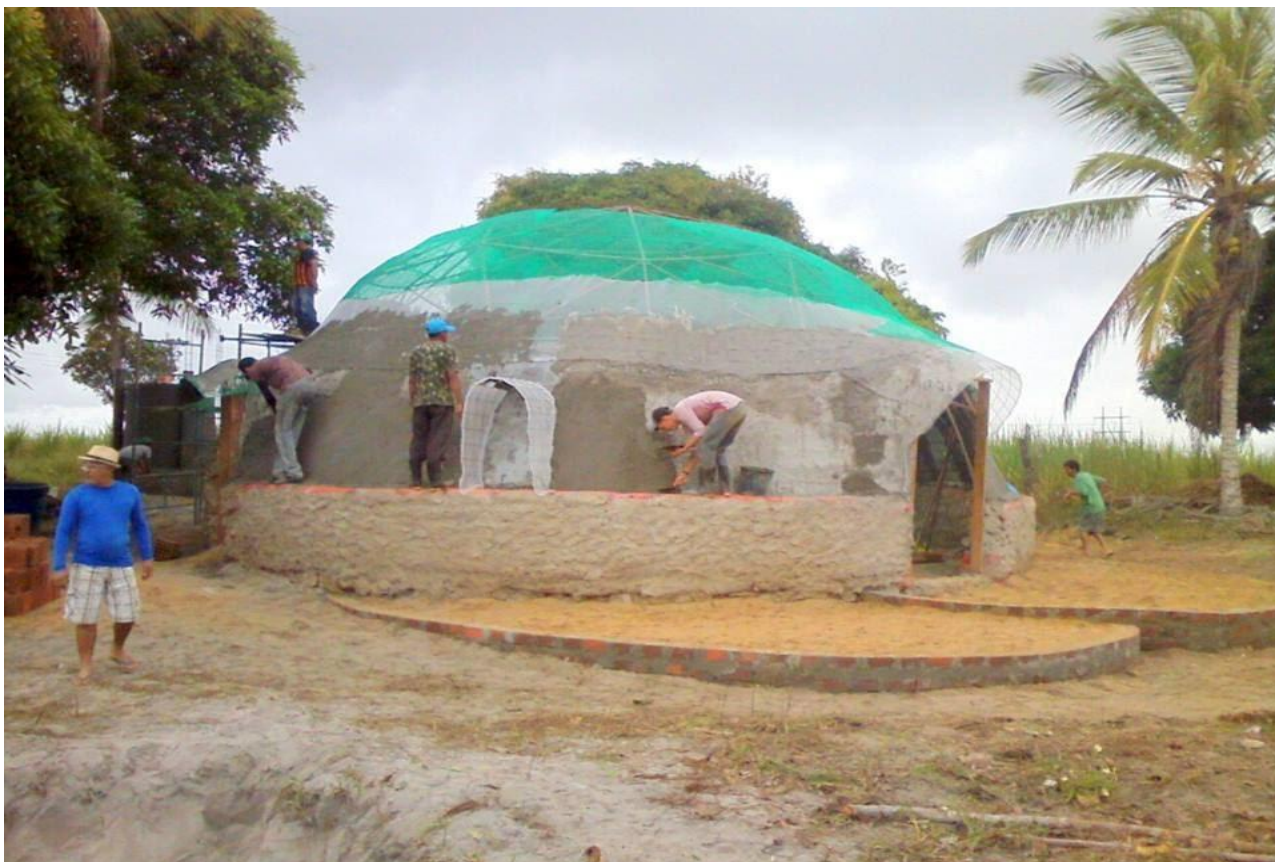
Fotos da primeira casa em forma geodésica na Paraíba, fruto de bioconstrução – ENEC/UFPB
